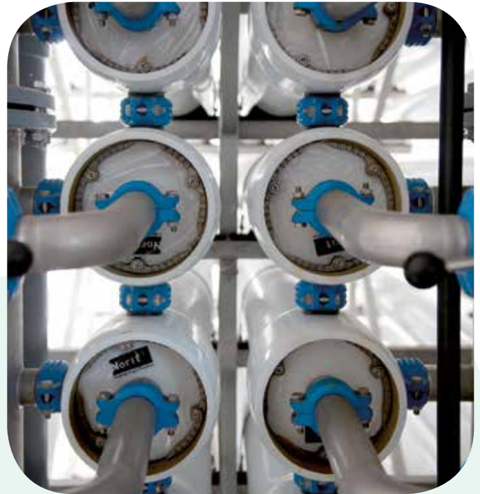
Modules d'ultrafiltration de l'unité de traitement de Pleven (Côtes d'Armor) – Photo agence TOTEM – Fabrice Picard
