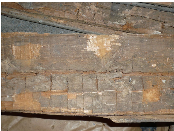
Planche « mérulée » qui a perdu ses propriétés mécaniques
