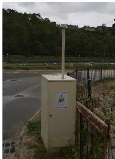
Figure 2 : Cabine installée sur le site du Légué
