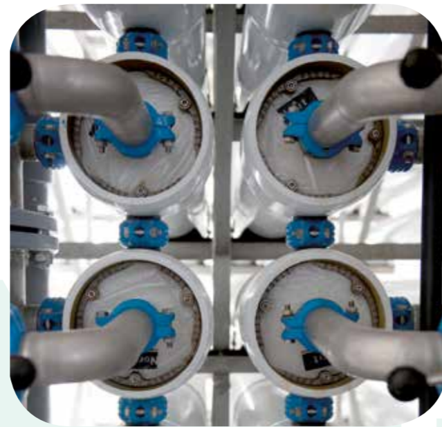
Modules d'ultrafiltration de l'usine de Pleven (22) – Photo agence TOTEM – Fabrice Picard
