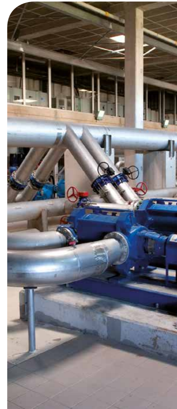
Salle des pompes de l'usine de traitement de la Ville Hatté à Pleven (22) – Photo SMAP (Syndicat mixte Arguenon-Penthièvre)
